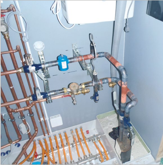
Tarvittaessa kaukolämmön mittauskeskus voidaan muokata tilaan sopivaksi.
